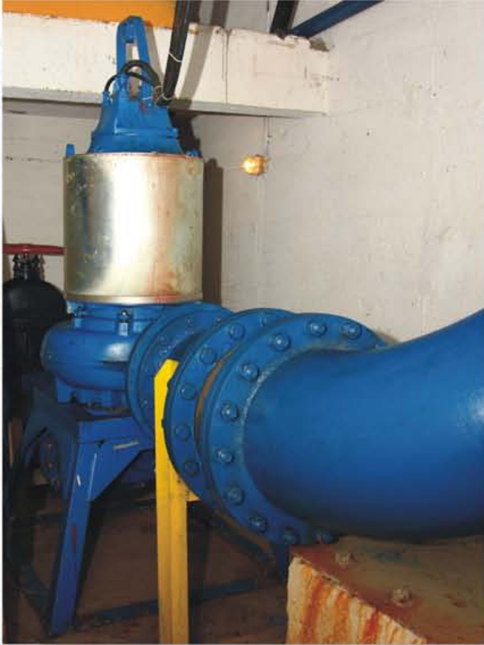
Fot. nr 15. Pompa Pumpex z zasuwą na rurociągu
